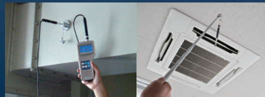
空調機器の能力試験・保守点検
